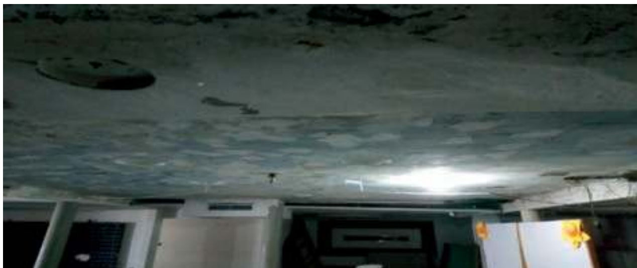
Vista de los techos, nótese las filtraciones y el mal estado.
