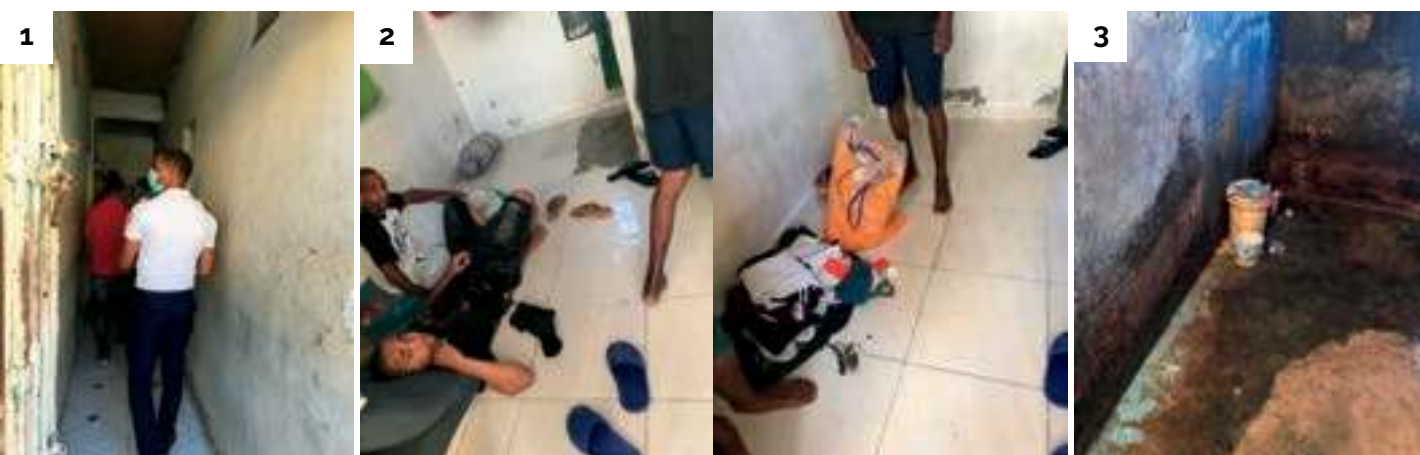
1. Nótese la falta de ventilación y luz natural, deben utilizar electricidad para iluminar y ventilar las áreas. 2. La falta de cama es notoria, muchos se ven obligados a dormir en el piso y en pasillos. 3. Vista de la condición de los baños.
