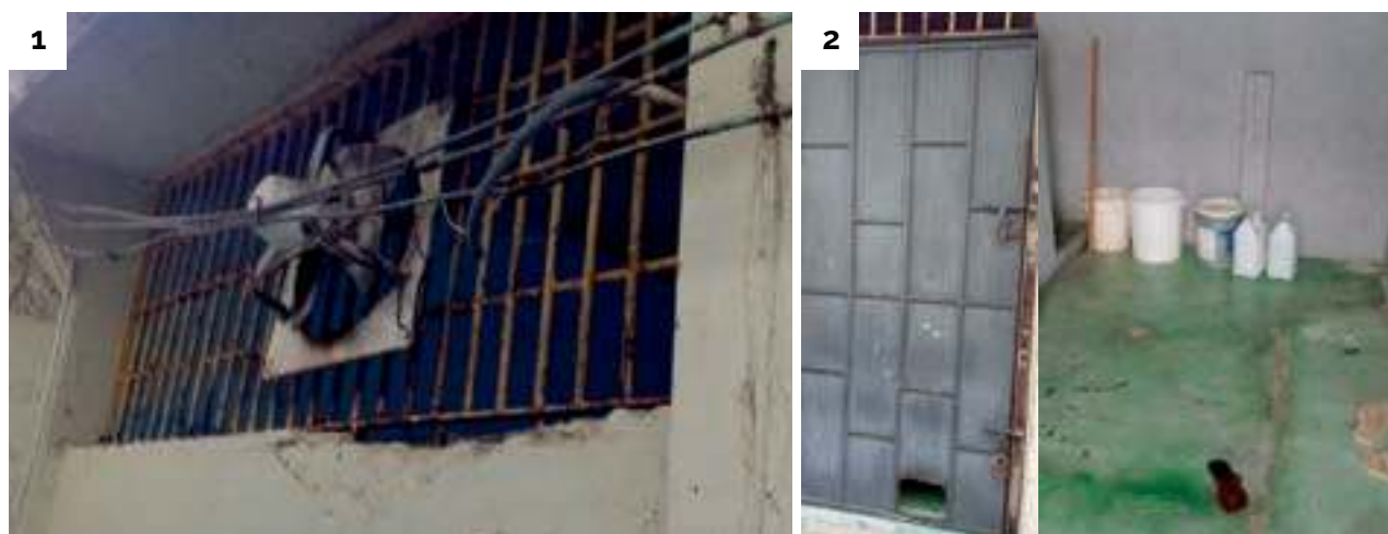
1. Vista de los ventiladores en las rejas. 2. Área de reflexión.
